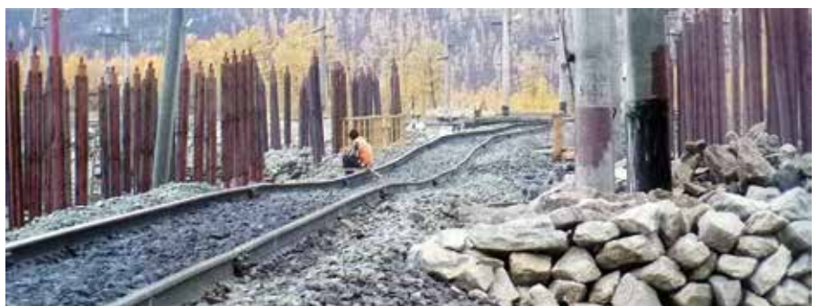
Рис. 2. Железнодорожный путь на участке 1373–1374 км ВСЖД в районе станции Казанкан с охлаждающей системой из каменной наброски и двух рядов вертикальных металлических труб с керосином (фото Е. А. Козыревой, сентябрь 2003 г.)
