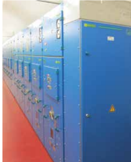
Рис. 7. Вид РУ-825 В СТП-8 станции «Площадь Восстания» после реконструкции. Проект 2015 г.
