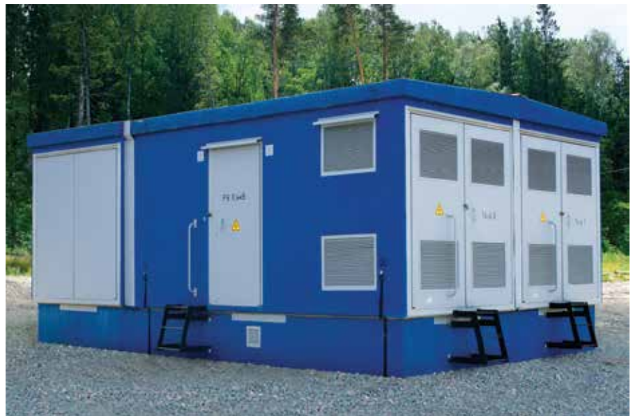
Рис. 2. Комплектное распределительное устройство в бетонной оболочке
